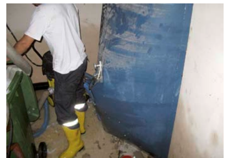
Durch Wasserdruck eingedrückte Stahltüre.
