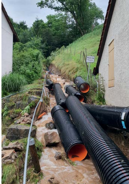
Schlamm- und Geröllmassen auf dem Weg zur Mühle Wolfsölden.
